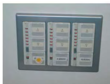
照度を調節する操作盤
