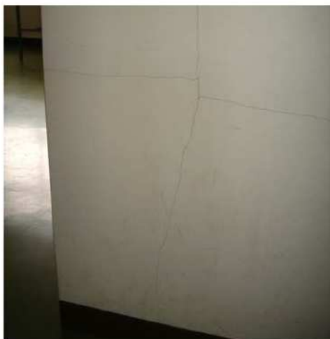
地震後の表面ひび割れ
