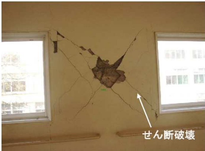
地震後の状況写真
