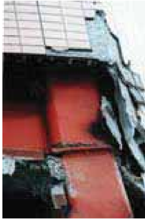
写真一7 柱とダイアフラム溶接部の破断 (兵庫県南部地震)
