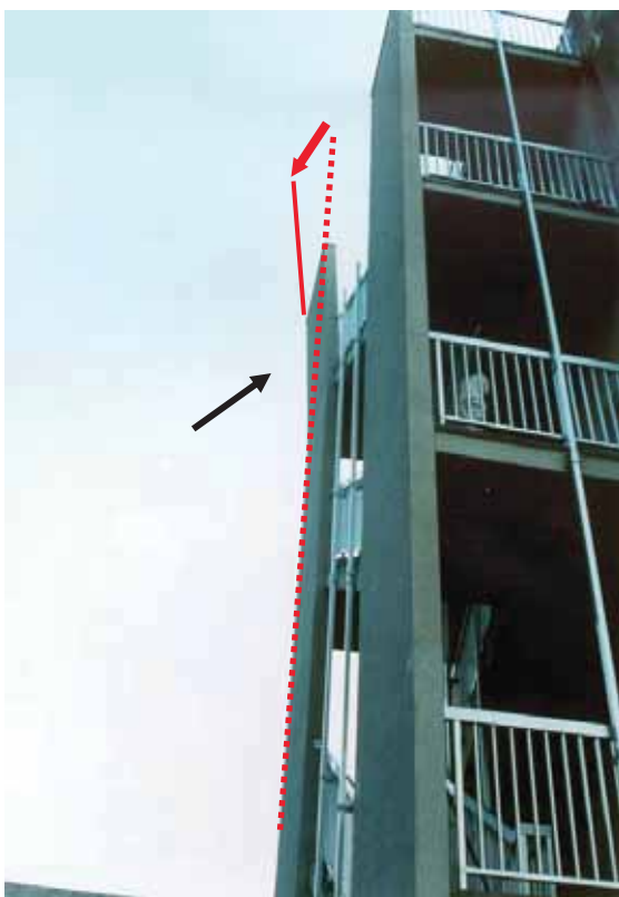
(a) 屋外階段の壁の転倒・落下危険性有り (1987年・千葉県東方沖地震／千葉大・村上研究室)
