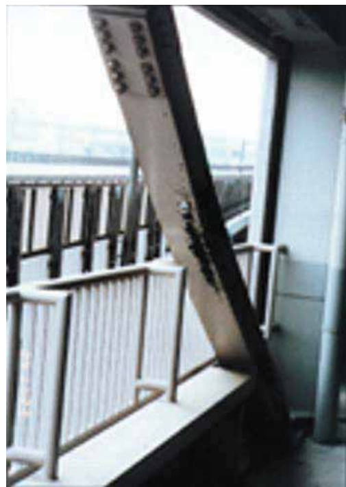
写真三 筋違の座屈 (兵庫県南部地震)
