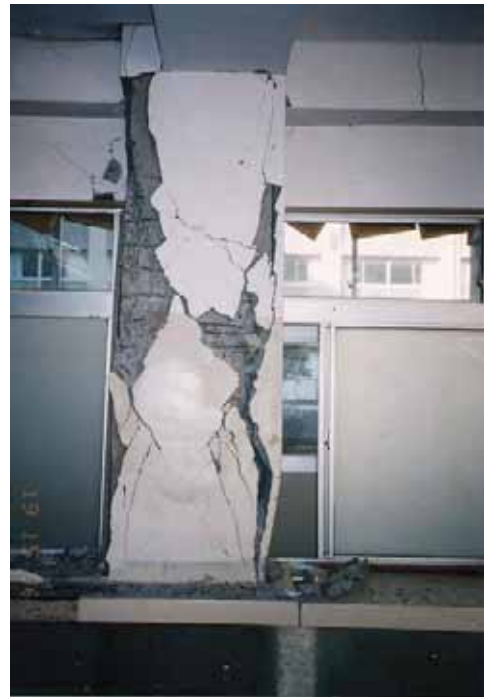
(c) 激しいコンクリートの剥落が見られ、鉄筋がかなり露出しているが、座屈や破断はみられない。(1995 年・兵庫県南部地震／東北大 前田研究室)
