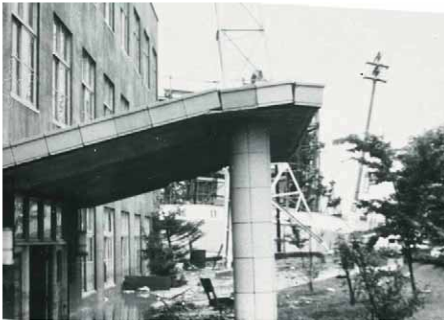
図-7 全体沈下が1mを超える被害例 (1964年・新潟地震／芝浦工大・岡田研究室)
