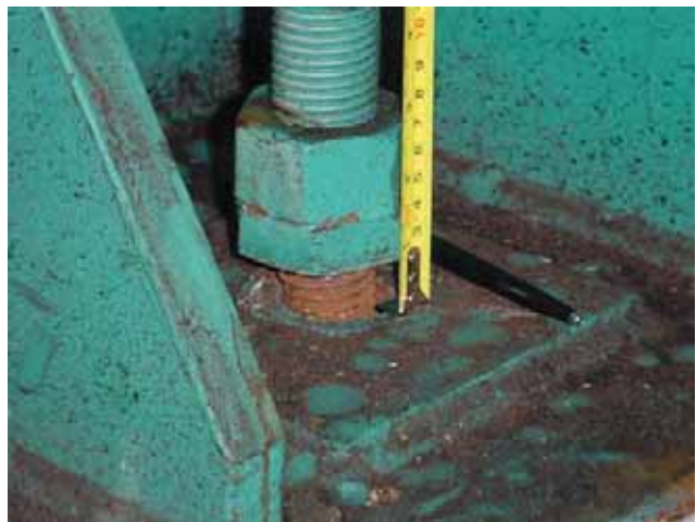
写真一 10 筋違を受ける露出型柱脚のアンカーボルト降伏 (ペルー南部 (Atico) 地震、東大生研大井研撮影)
