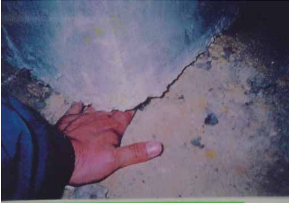
写真－13 屋内運動場の木造床を支える束立ての移動 (兵庫県南部地震 東大生研大井研)
