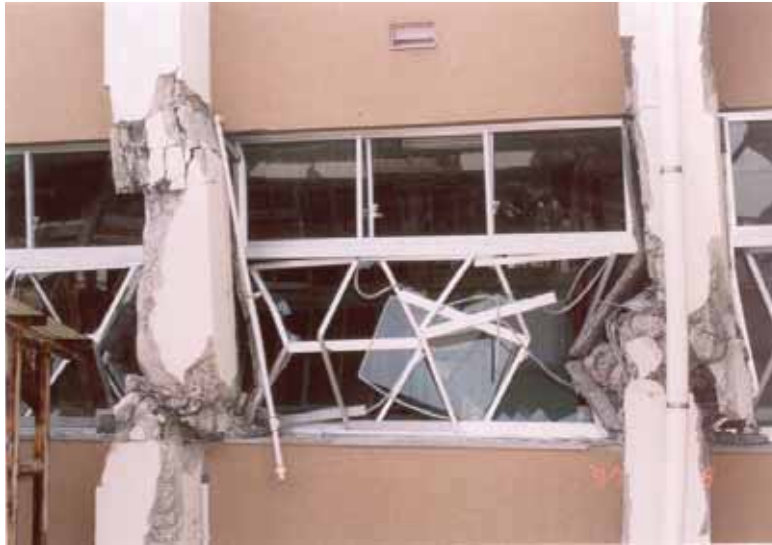
(c) 柱頭および柱脚が曲げせん断破壊し高さ方向に変形が生じている。 (1997年・鹿児島県北西部地震)
