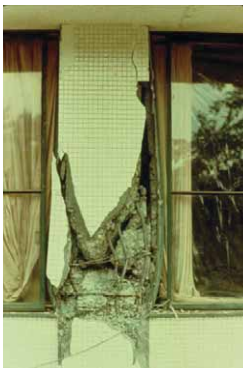
(b) 鉄筋が曲がり、内部のコンクリートも崩れ落ち、一見して柱の高さ方向に変形が生じていることがわかる。(1978年・宮城県沖地震)
