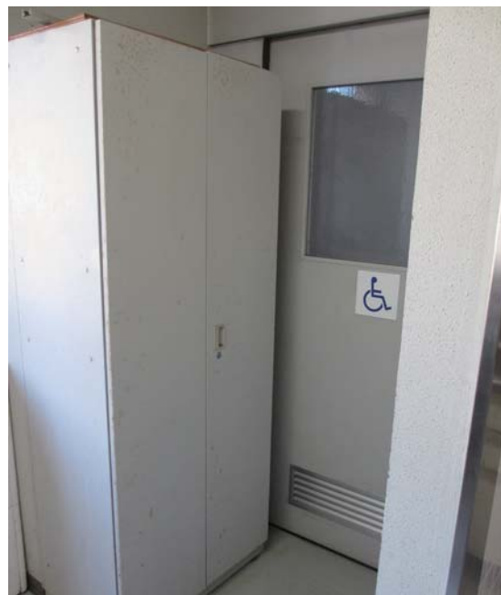
図-2 多目的トイレの扉前に置かれたキャビネット
