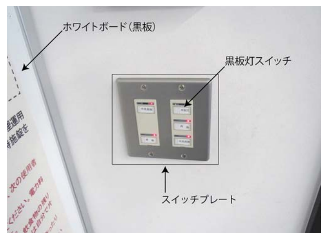
図-2 照明スイッチ
