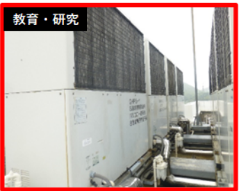
設置後19年経過、故障が頻発する室外機(医学部本館)
