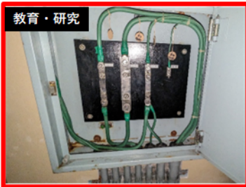
接地端子の発錆(本部棟)
