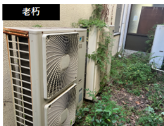
設置後20年経過、故障頻度が増加傾向 (動物飼育・心理実験室)
