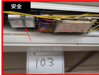
低濃度PCBの疑いがあるコンデンサが設置。
