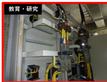
老朽化した配電盤(廃水処理施設)
