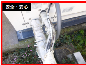
冷媒管の破損室外機(学生会館)
