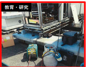
温度調整が効かない→コンプレッサー修理(地域科学・共通教育棟D棟)
