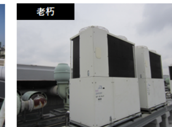
設置後20年経過、故障が頻発する室外機 (基礎研究棟別館)
