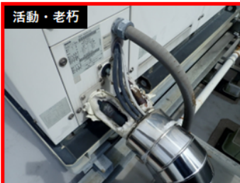
冷媒管の破損、フロンガスの漏洩 (法・経本館共用館)
