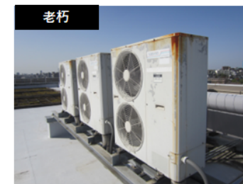
設置後18年経過、故障頻度が増加傾向 (工学部3号館)
