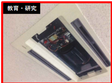
室内機からのドレン水漏れによる空調停止→ドレン修理(医学部教育・福利棟)
