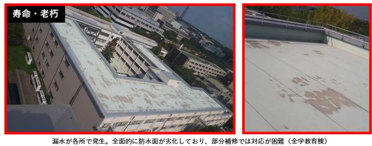
漏水が各所で発生。全般的に防水面が劣化しており、部分補修では対応が困難 (全学教育棟)
