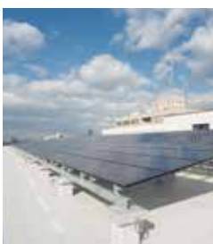
屋上の太陽光発電パネル
