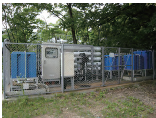
井水浄化装置
