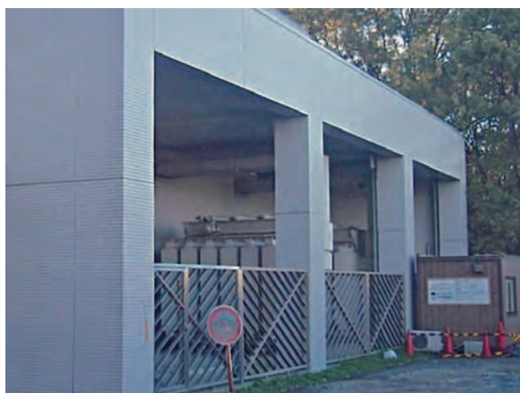
工事前の変電設備
